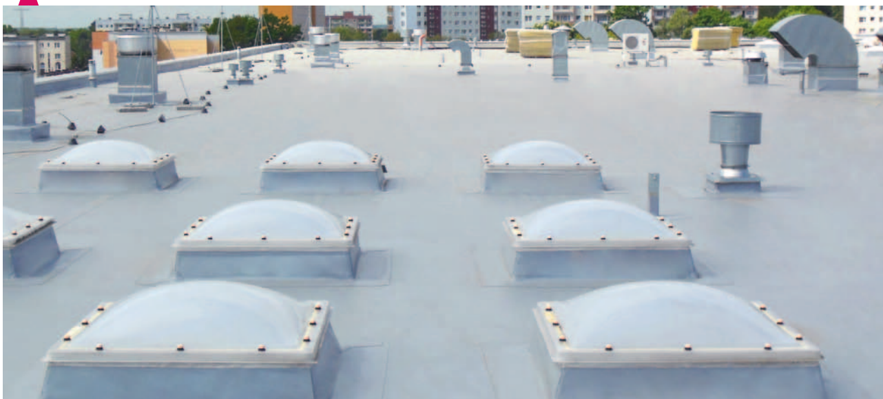
Польша, г. Эльблонг, торговый центр «Огороды», 25 000 м 2
